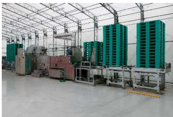
兵庫第2流通センター/パレット洗浄システム
